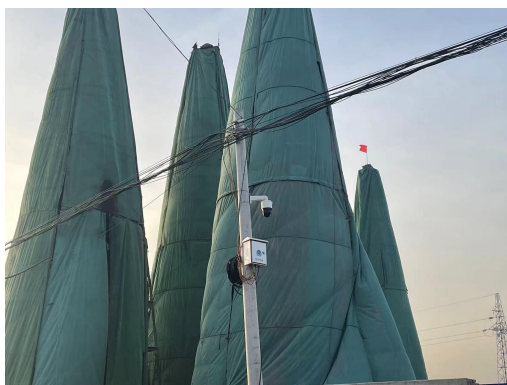
图 2.2-5：杨套楼工业场地副井钻机降噪措施
